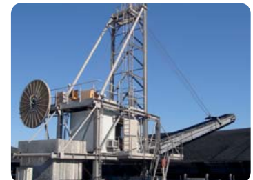
Reprise par grappeur latéral à 250 t/h de laitier. Longueur de flèche : 26 m - Hauteur de tas : 13 m Angle de travail : 42° Reclaiming of slag by lateral scraper at 250 t/h. Boom length : 26 m - Stockpile height : 13 m Slope angle : 42°
