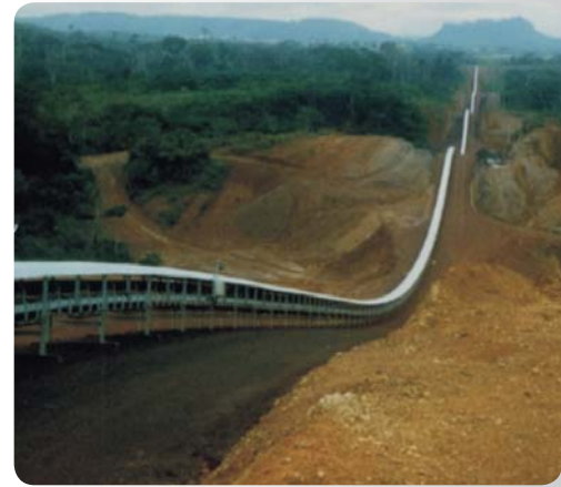
Curvodic™ de 6 km au Gabon. Liaison carrière-usine d'expédition en minerai de manganèse à 800 t/h
