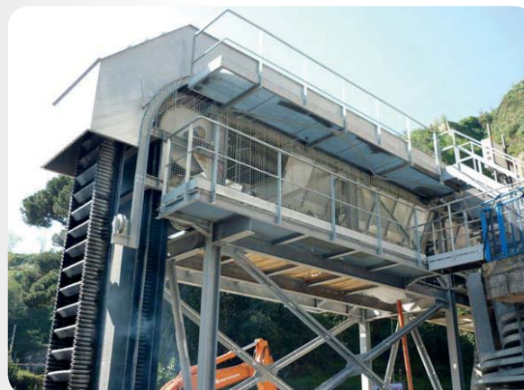
Bande à bord permettant de remonter à la verticale de 5 m à 250 m. Équipé d'un système de nettoyage.
