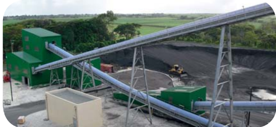
Centrale charbon, criblage, broyage, stockage, déchargement camion - débit : 150 t/h
