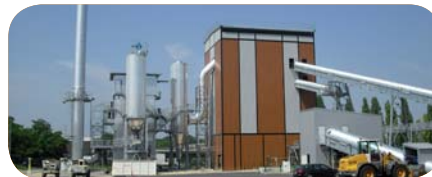
Installation complète de stockage Biomasse (4000 m 3 ).
